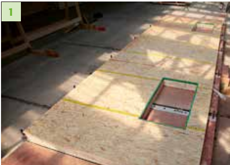
1 Mit SWISS KRONO OSB beplanktes Wandelement auf dem Montagetisch, bei dem noch die Fenster eingesetzt werden müssen.
